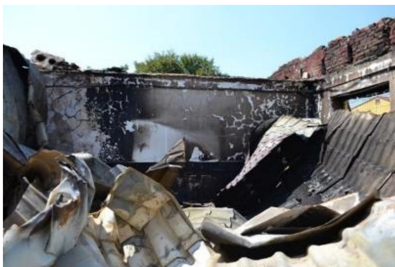
Fig. 17. Foto constatări incendiu produs într-o unitate școlară. Se remarcă amprenta incendiului, propagat de sus în jos, prin podul clădirii, cu arderea și prăbușirea tavanului.
